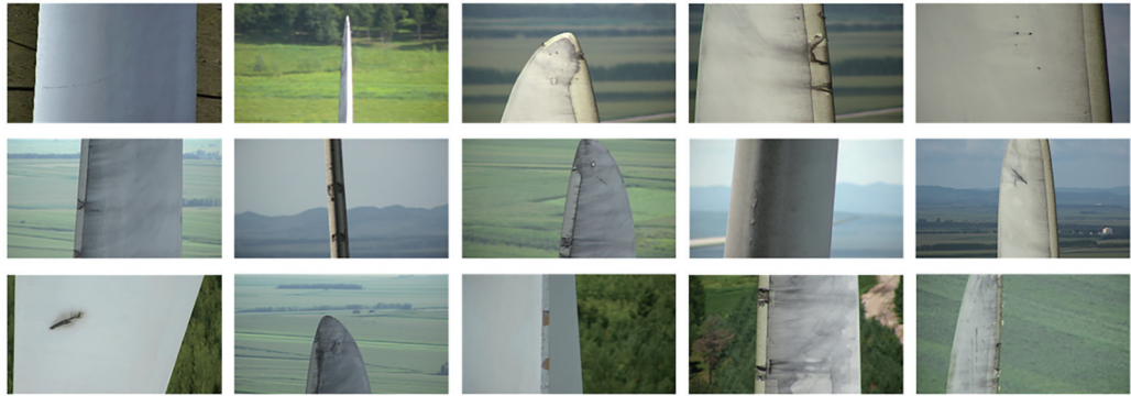
图 10 叶片损伤初步识别的典型示例 (损伤风机叶片)
